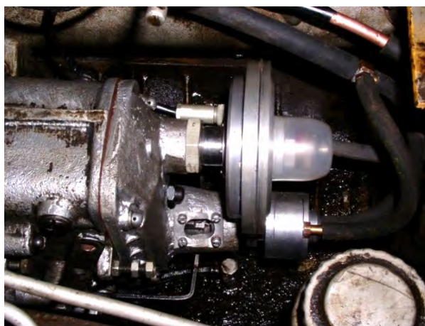
Установка агрегатів системи на двигуні
